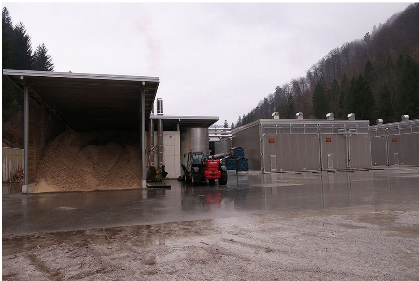
Kotlovnica na lesne sekance ter sušilnice žaganega lesa (foto: Špela Ščap)
