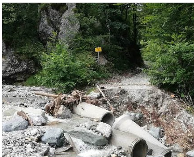
Slika 5: Po zamašitvi dvojnega cevnega prepusta, je hudournik odnesel približno 10 m odsek gozdne ceste (Foto: Jaša Saražin)
