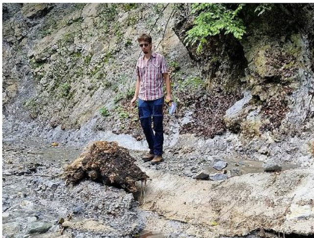
Slika 7: Beton je poskrbel, da sta jašek in cevni prepust ostala na svojem mestu tudi po tem, ko je hudournna voda odnesla celotno vozišče (Foto: Urša Vilhar)
