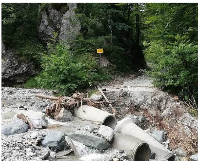
Slika 5: Po zamašitvi dvojnega cevnege prepusta, je hudournik odnesel približno 10 m odsek gozdne ceste (Foto: Jaša Saražin)
