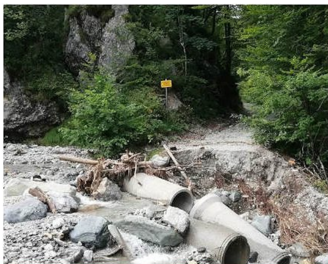
Slika 5: Po zamašitvi dvojnega cevnega prepusta, je hudournik odnesel približno 10 m odsek gozdne ceste (Foto: Jaša Saražin)
