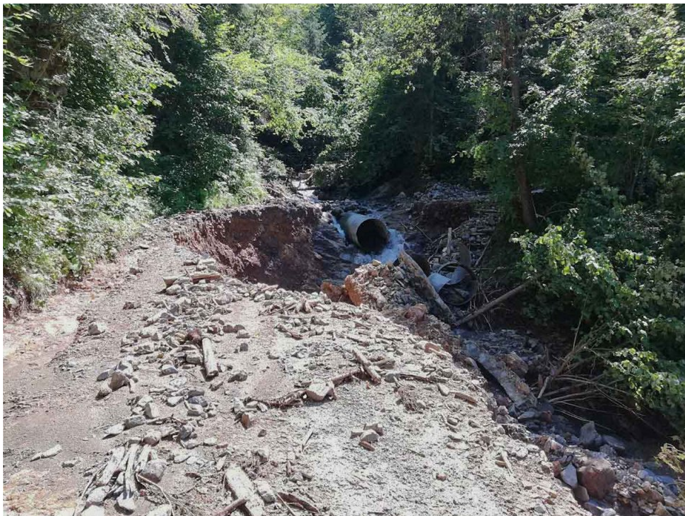
Slika 2: Hujše poškodbe gozdne ceste nad Črno na Koroškem kot posledica zamašenega velikega cevnega prepusta.
