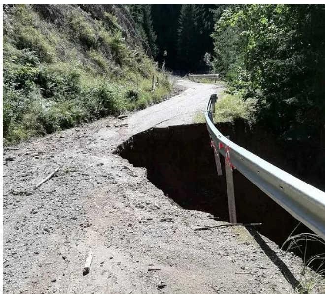
Slika 9: Večji usad na gozdni cesti. Brez ustrezne sanacije ta gozdna cesta še dolgo ne bo prevozna za tovorna vozila
