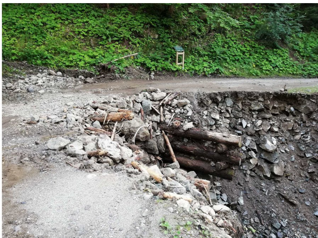
Slika 5: Zasilno vzpostavljena prevoznost prometnice za osebna in intervencijska vozila po tem, ko je drobirski tok odnesel lesen most. Gozdne prometnice so bile marsikje ključne za dostop interventnih služb, tako do kmetij, kakor tudi do naselij, kjer so bile javne prometnice neprevozne.
